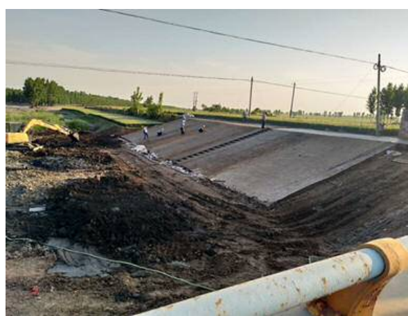
中国で実証を行う固化汚泥を用いた護岸整備 楽しい(株)
