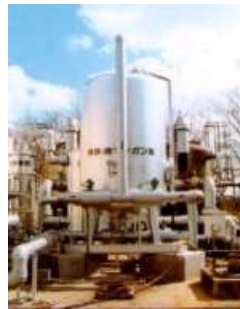
急速除鉄除マンガン装置
